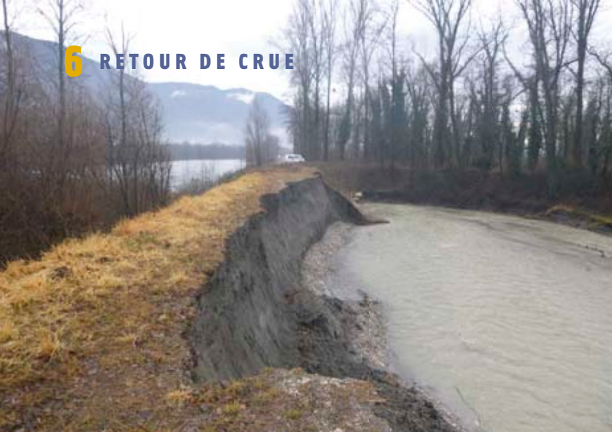
La digue de l'Isère en amont de la confluence avec le ruisseau de Sainte-Marie-d'Alloix.
