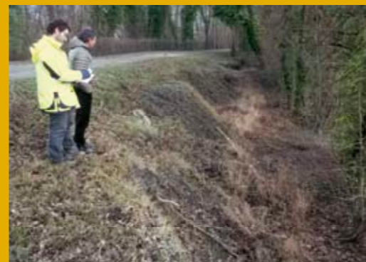
Romain Cloix, inspecteur de la DREAL, et Michel Pinhas, directeur de l'AD, constatent le glissement de talus à la Taillat.
